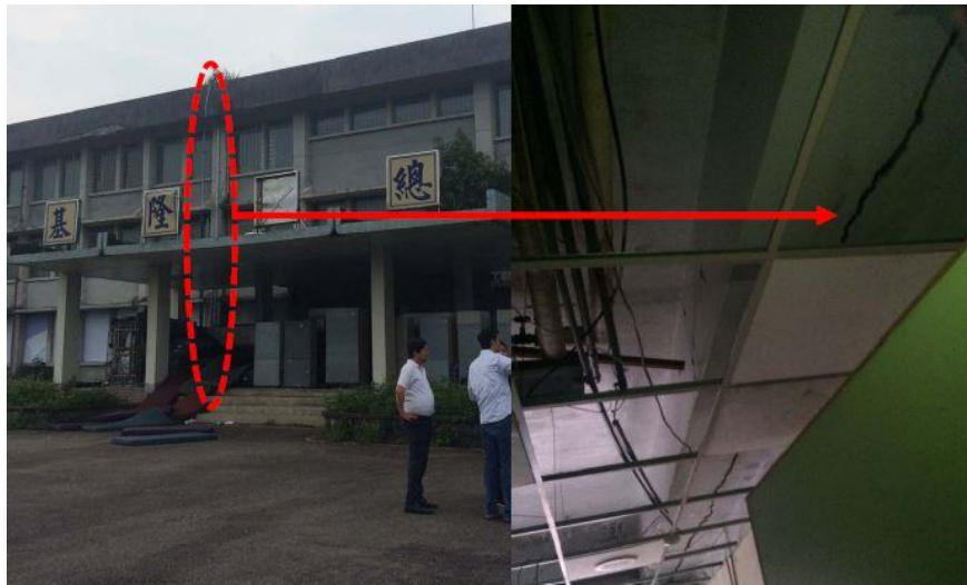
圖 4-2-1 住院大樓伸縮縫現勘照片示意圖
